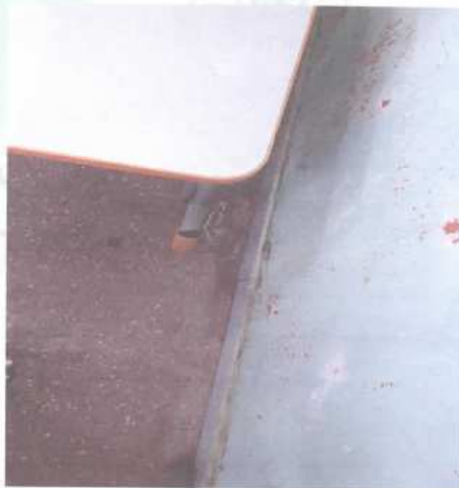
34-Infiltração na parede na sala 1º ano
