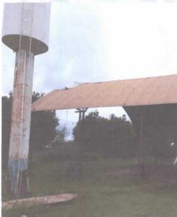
41- telhas soltas na quadra
