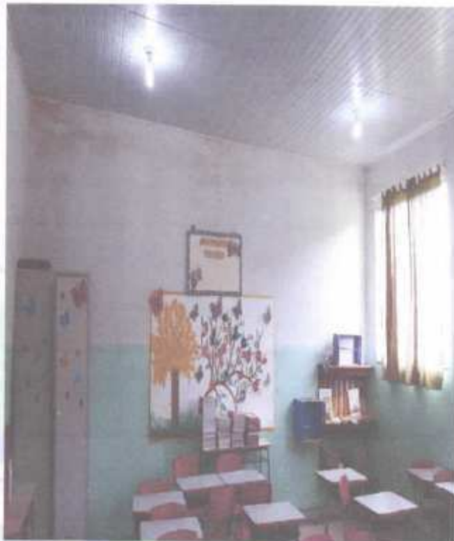
32-Parede com defeito e infiltração na sala do 3º ano
